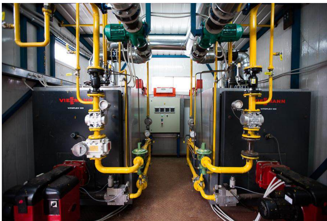
Рисунок 2. Внутренний вид котельной.
