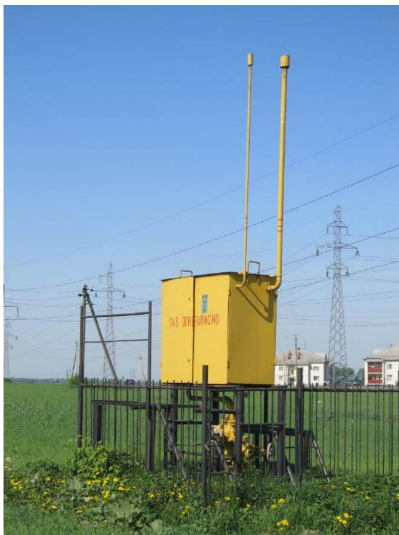
Рисунок 13. Шкафной газорегуляторный пункт.
